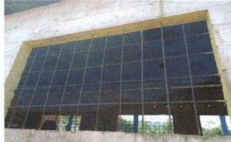
FOTO 8: Sustrucción de balcones de metal (AULA)
