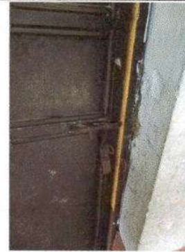
FOTO 4: Sustrucción de chapa (AULA)
